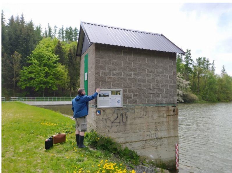
Zaměstnanci KHS MSK při instalování informační cedule na nádrži Budišov nad Budišovkou, okres Opava, Foto: KHS MSK
